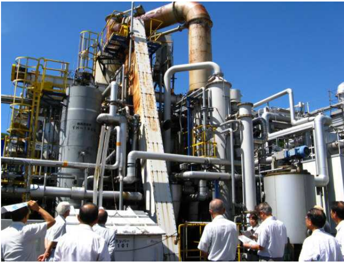
電中研のバイオマス発電実験プラント
